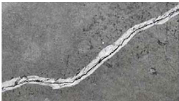
Рисунок 3. V-образная канавка вдоль трещины
